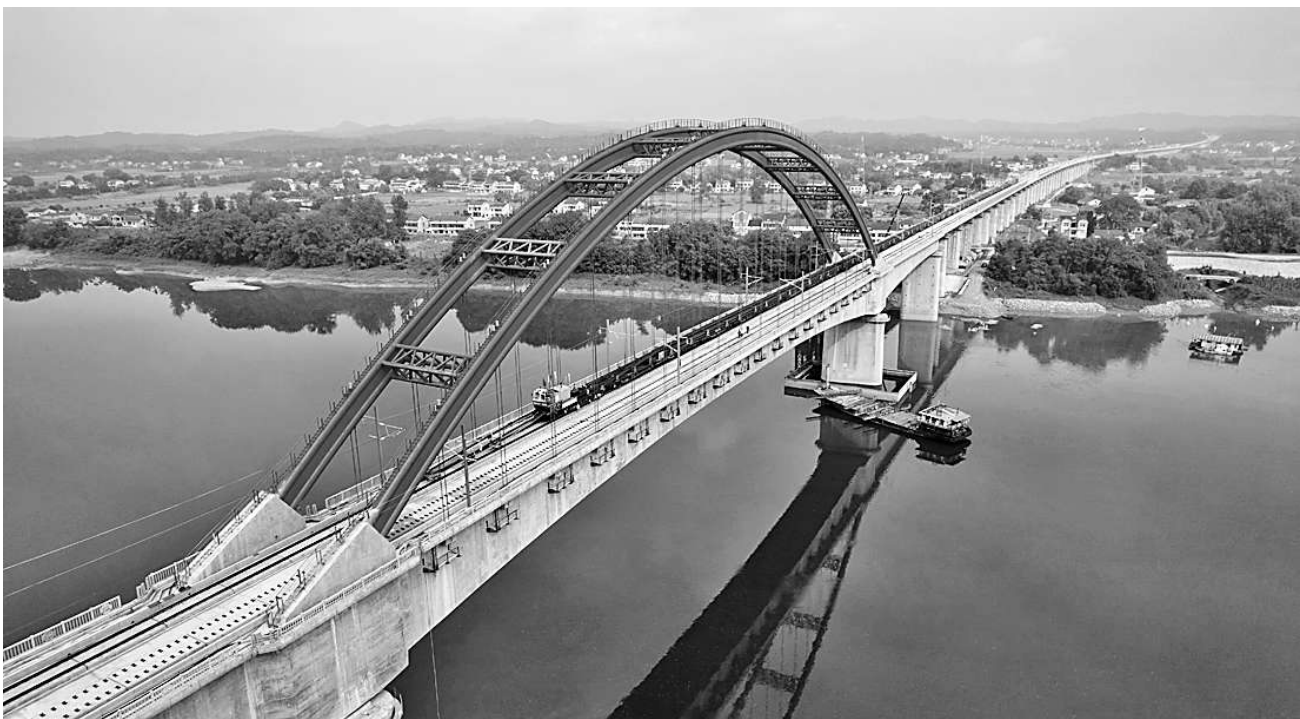
常益长铁路铺轨顺利通过资水特大桥 7月18日,轨道铺设顺利通过常(德)益(阳)长(沙)铁路控制性工程资水特大桥,为常益长铁路早日通车运营奠定基础。图为7月18日,一辆长轨运输车正在通过常益长铁路资水特大桥。 新华社记者 陈思汗摄
