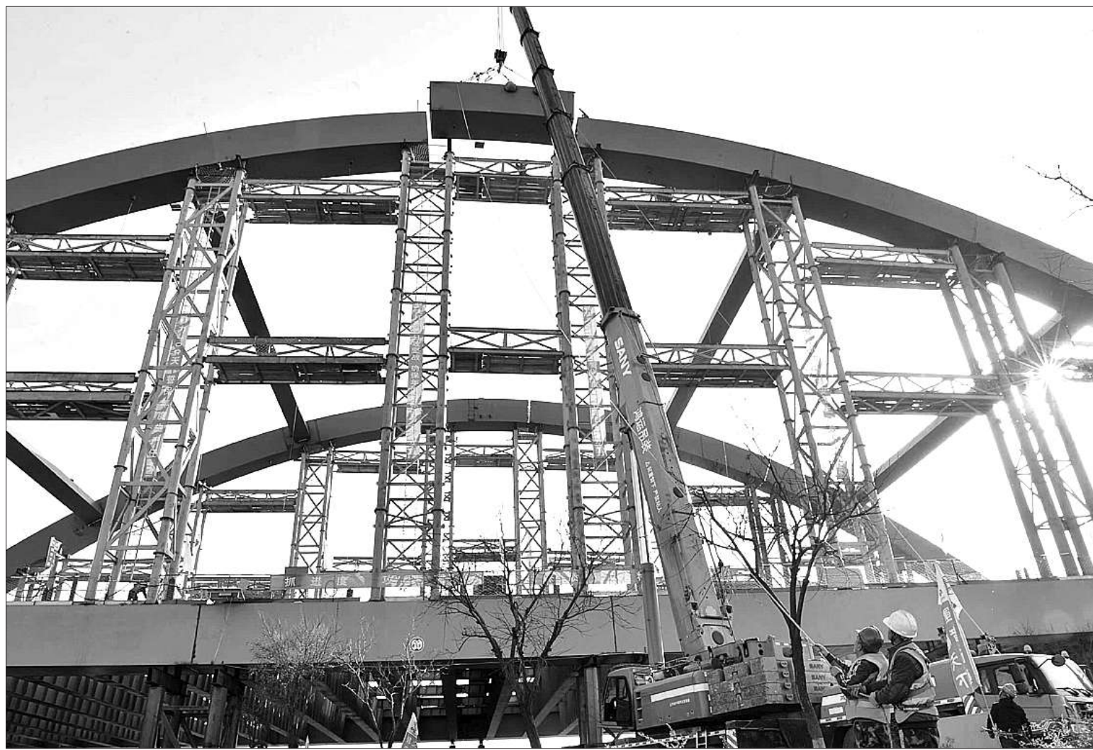
京秦高速滦河特大桥主桥顺利合龙 11月14日下午,河北省迁安市境内的京秦高速(遵化)秦(秦皇岛)段标志性建筑滦河特大桥主桥顺利合龙,提前一个半月完工。京秦高速是国家“十三五”规划和省部重点建设项目,是连接北京和秦皇岛、沈阳及东北地区的一条高速公路,全长264公里。目前,北京至遵化段已通车。遵秦段线路预计2022年年底建成通车。全线通车后,秦皇岛至北京将至少缩短半小时车程,京津冀交通一体化进程将大大提速。 李彬摄/光明图片
