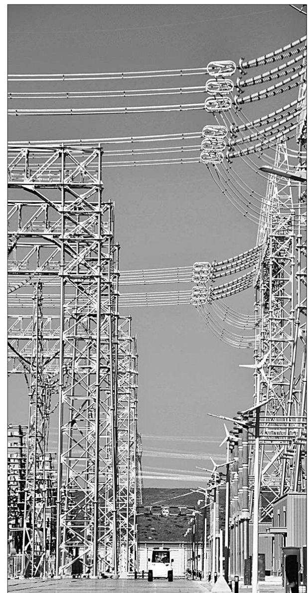
青豫直流工程已累计外送青海清洁电量156亿千瓦时 青豫直流工程起于青海省海南藏族自治州,止于河南省驻马店市,途经青海、甘肃、陕西、河南4省,线路全长1563千米,于2020年12月30日全面建成投运。图为青海-河南±800千伏特高压直流工程特高压青南换流站一角。新华社记者 陈凯摄
