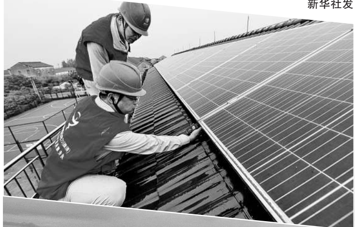
浙江省德清县新安镇合西村,工作人员在检查村民屋顶的太阳能光伏板并网发电情况。 新华社发
